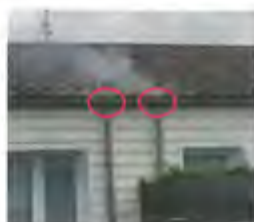
Exemple d'analyse effectuée par un test à la fumée, avec cette gouttière raccordée au réseau d'eaux usées.
