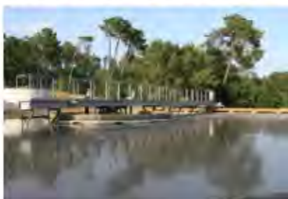
Une grande partie des eaux usées est traitée à la station d'épuration de Saint-Palais-sur-Mer. ANDRÉ BOUAFI/CPA
