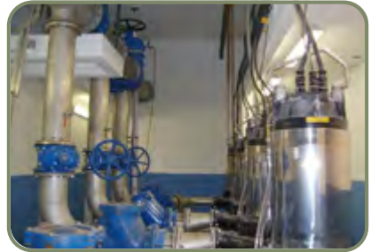
Postes de refoulement du « Rhâ » à Saint-Palais-sur-Mer.
